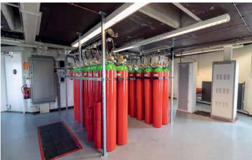
De blusgasinstallatie bestaat uit ruim dertig blusgasflessen van elk 80 liter, verdeeld over twee aparte opstellingen bovenin de betonnen toren, om zo de vloerbelasting gelijkmatiger te verdelen.
